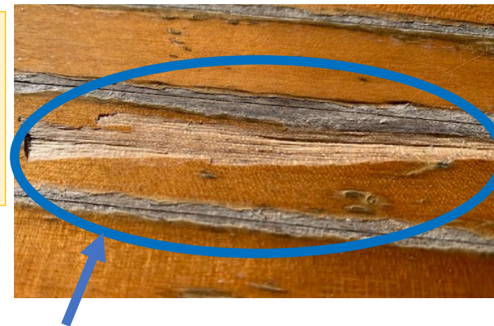
屋内運動場の床の破損（雨漏りが重なり、床が大きく剥がれた）
